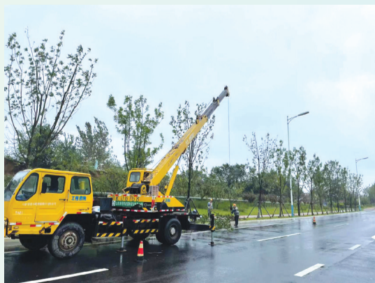
树木倒伏现场作业。本报记者 刘鹏雪 摄
